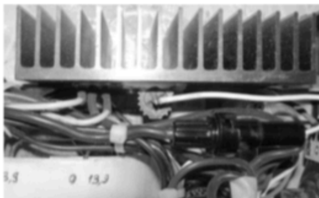
Рис. 5. Вид сверху на монтаж блока диодов Шоттки (слева) и резистора (в центре (22 Ом, 25 Вт)) на правом радиаторе БП
